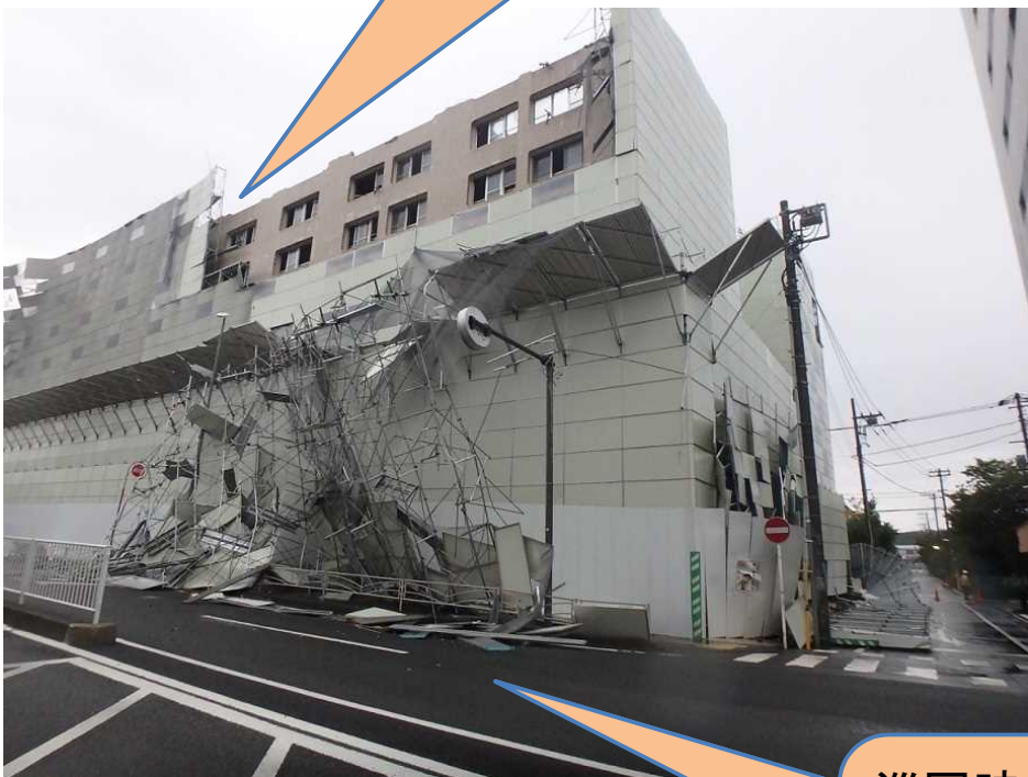
東側足場倒壊状況
